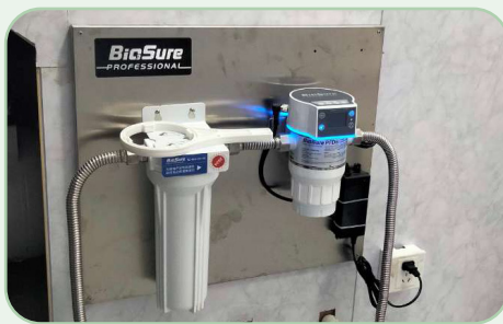
Vorbeugende Wartung Wasserleitungen
