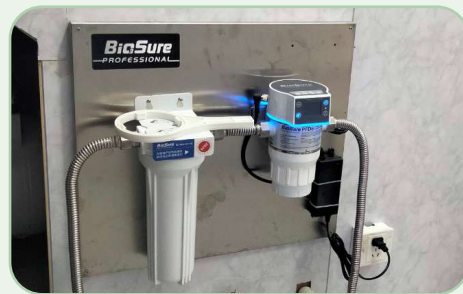
Vorbeugende Wartung Wasserleitungen
